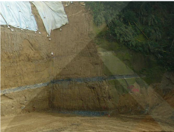
照片 3、破壞裸露面、基礎積水
