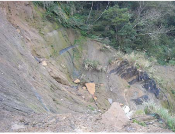
照片 2、坍塌之加勁結構
