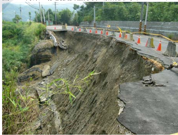
照片 1、坍塌界面陡直，形似平面滑動破壞
