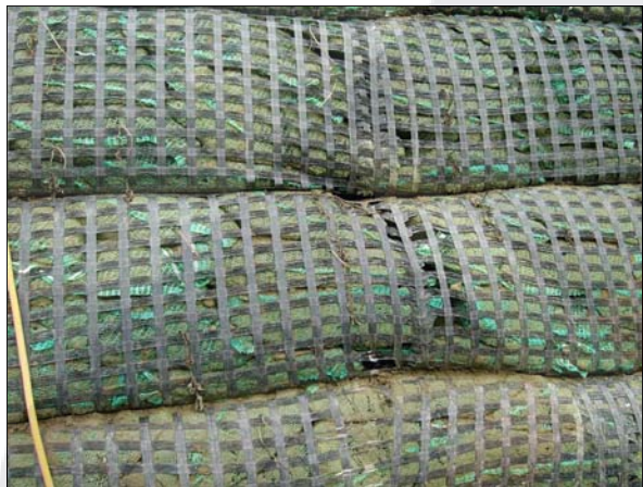
照片 6 加勁格網橫向肋條斷裂
