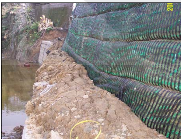
照片 7 地基承載破壞
