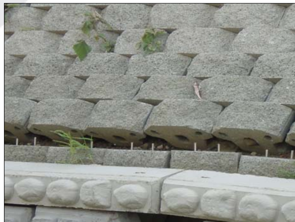
照片 4 牆面接點破壞
