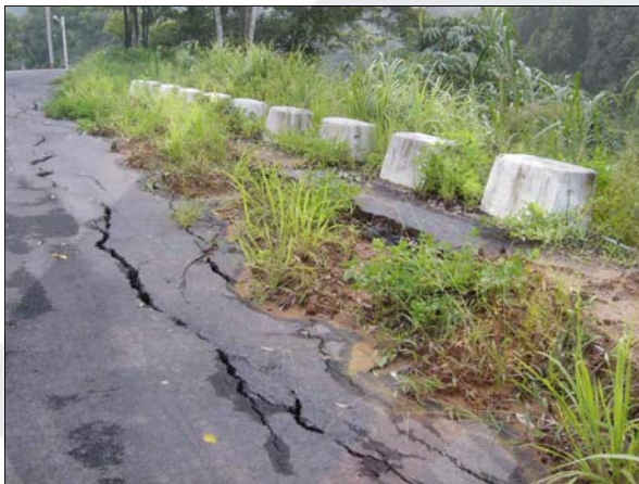
照片 2 牆面外傾、開裂
