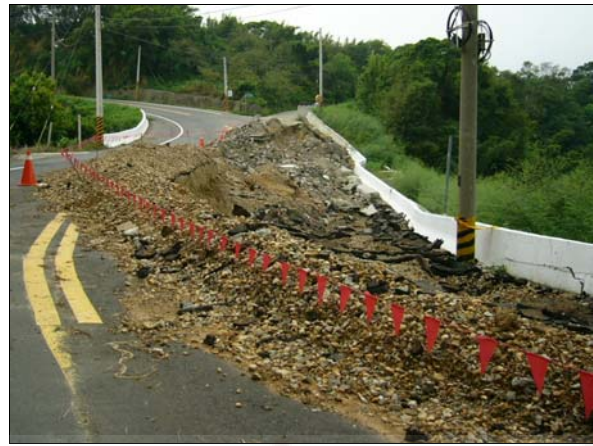
照片 3 牆頂沈陷開裂
