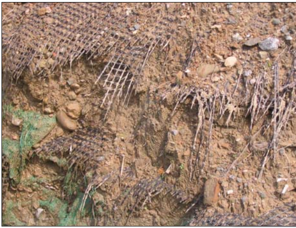
照片 5 加勁格網縱向斷裂
