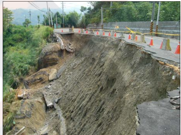
照片 8 全面坍塌破壞
