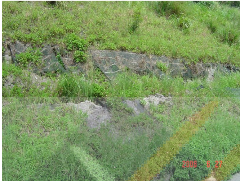
照片 4 緩坡掛網沖蝕情形
